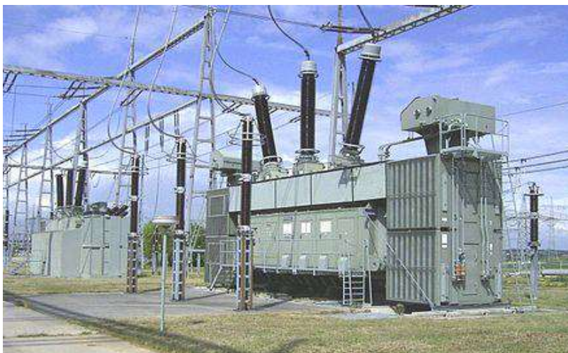
Figure I.13. Transformateur de puissance d'un poste électrique HT
