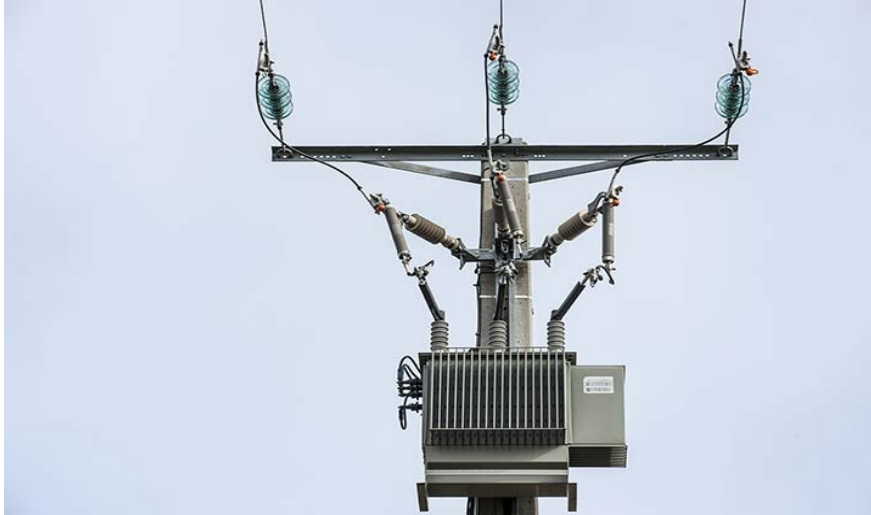
Figure I.12 : Poste de distribution sur support
