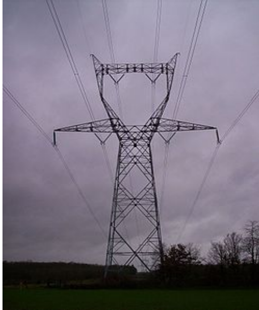
Figure I.7 : Pylône THT pour une ligne de 400kV
