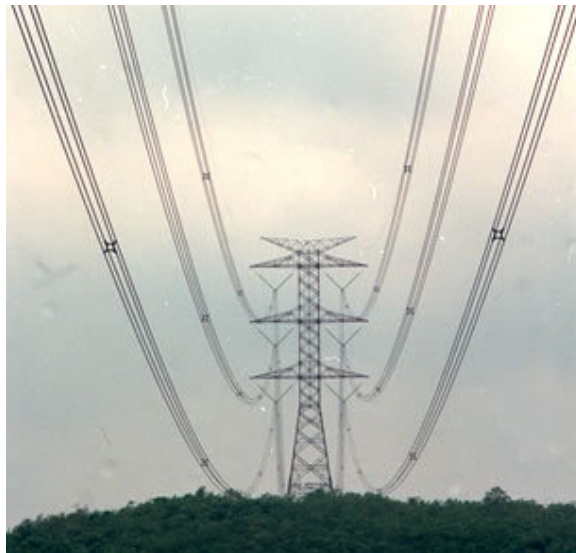
Figure I.8 : Ligne aérienne triphasée de transport d'énergie à doublé circuit
