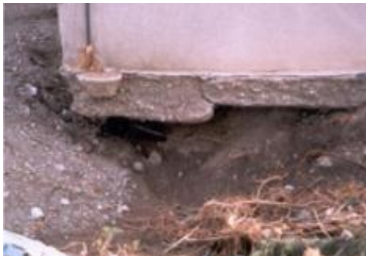
Figure 131 : fondation affouillée s : https://hal-csbtb.archives-ouvertes.fr/hal/-01064721/document
