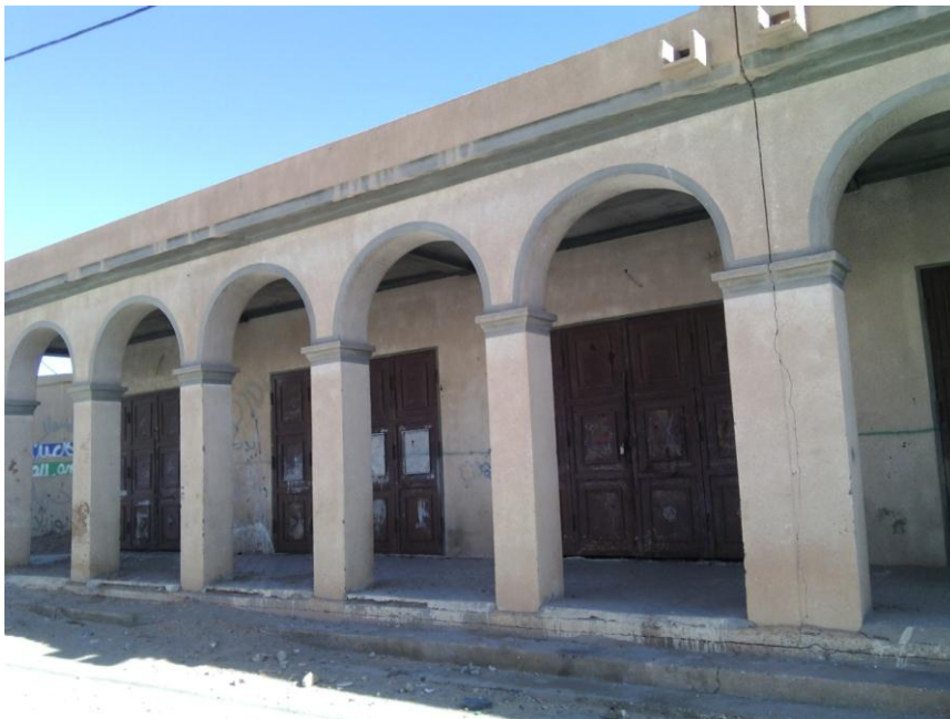
Figure 96: des locaux commerciaux abandonnées, source: auteu
