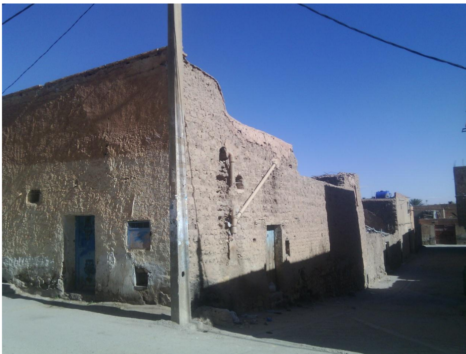
Figure 72: Vue sur un habitat traditionnel dégradé ,source : auteur
