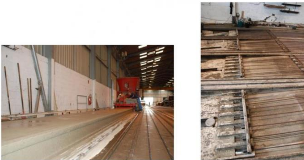
Fig. I- 10 exécution des planchers par une machine à coffrage glissant (extrusion) et vue des ancrages de torons aux extrémités du banc
