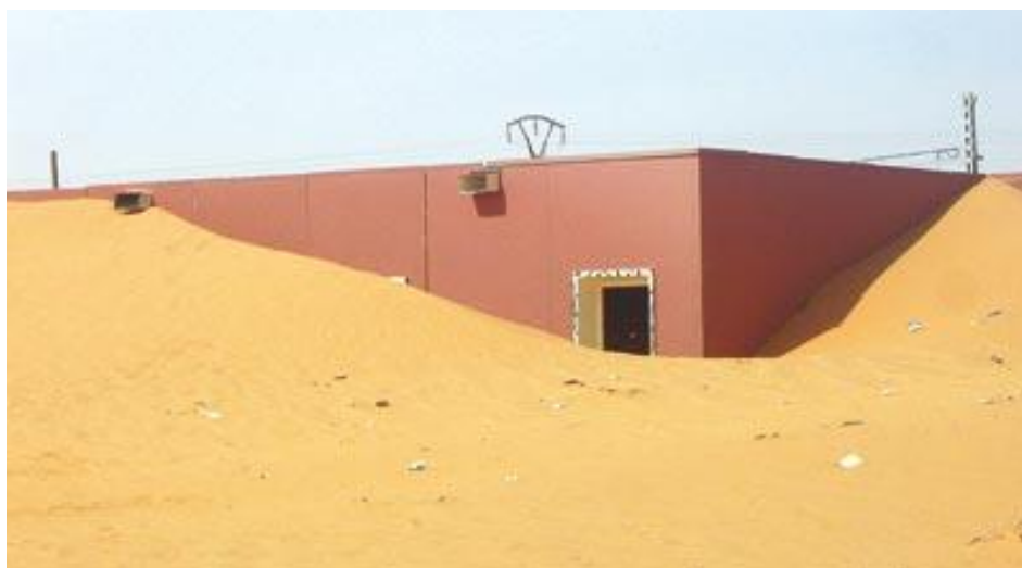
Fig.4.17. Accumulation de sable sur les murs extérieurs.
