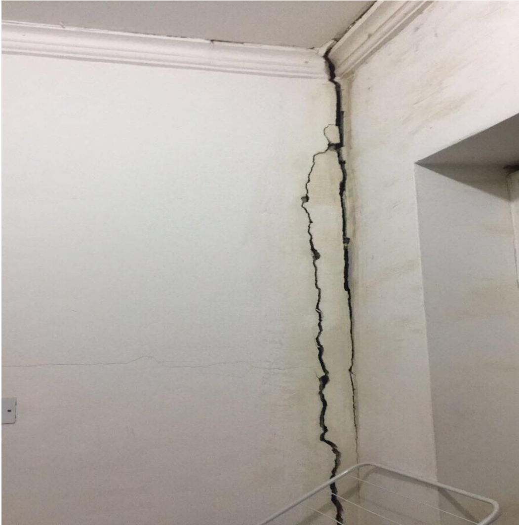
الشكل 1-2: شروخات رأسية
