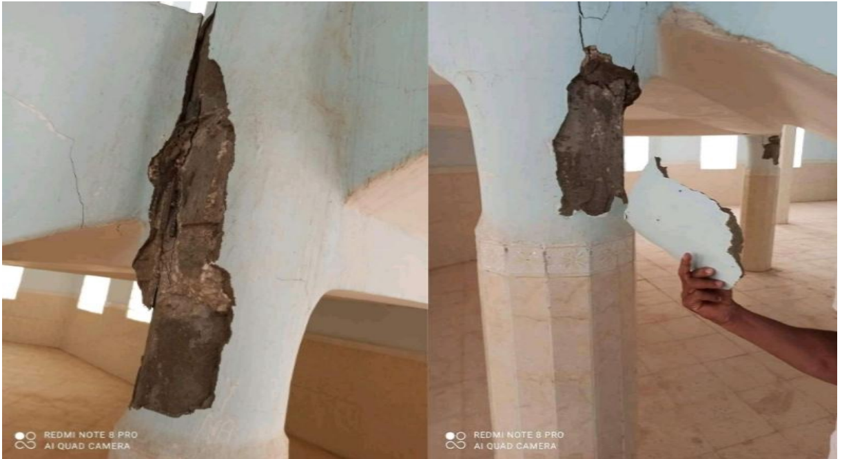
الشكل 3-19: أضرار هيكلية خرسانية
