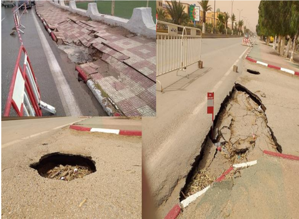
الشكل 1-4: هبوط مستوى التربة نتيجة لزيادة رص التربة بفعل مياه الأمطار. (الأغواط – حي المقام على امتداد الطريق الوطني رقم 01-)
