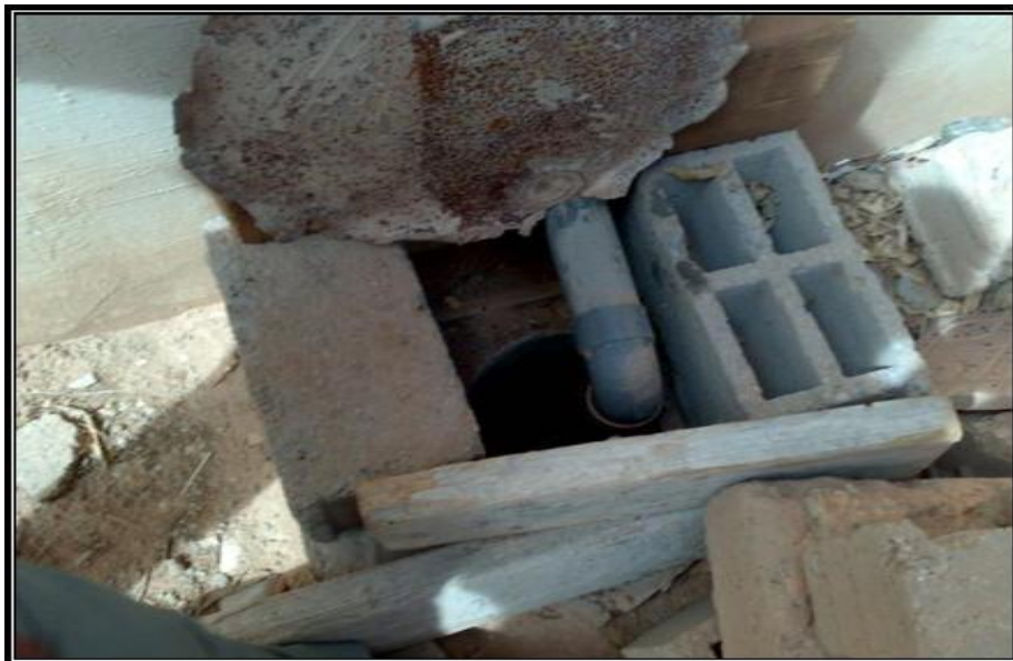
الشكل 3-9: مظهر لغرف تفتيش الصرف الصحي.
