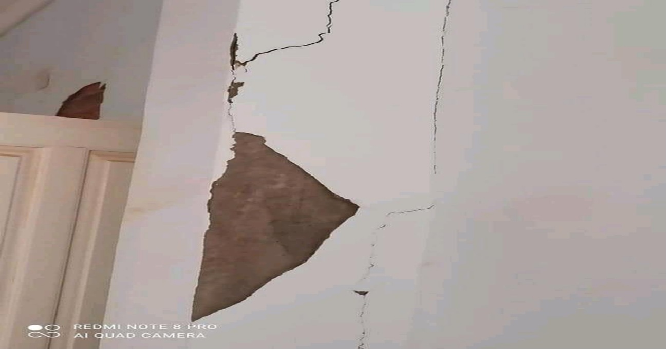
الشكل 3-14: تشققات الأعمدة في قسم الهندسة الكهربائية
