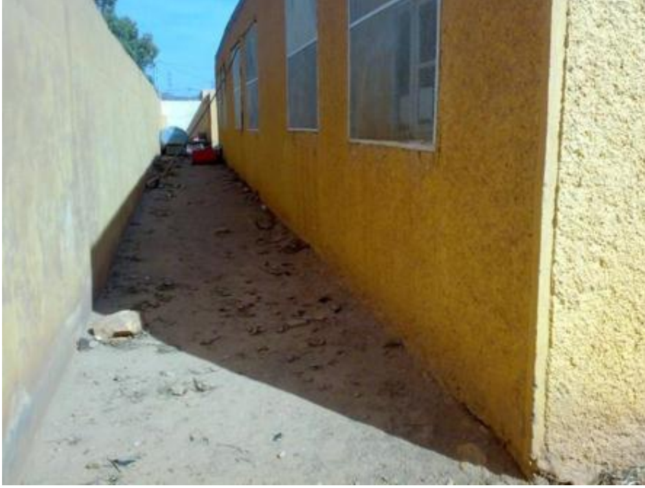
الشكل 3-12: عدم وجود رصف
