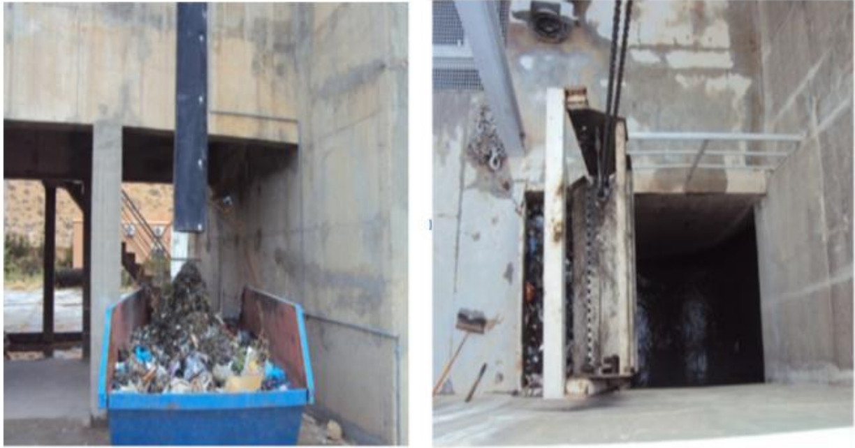
Figure 32 : le dégrillage (STEP de Laghouat).
