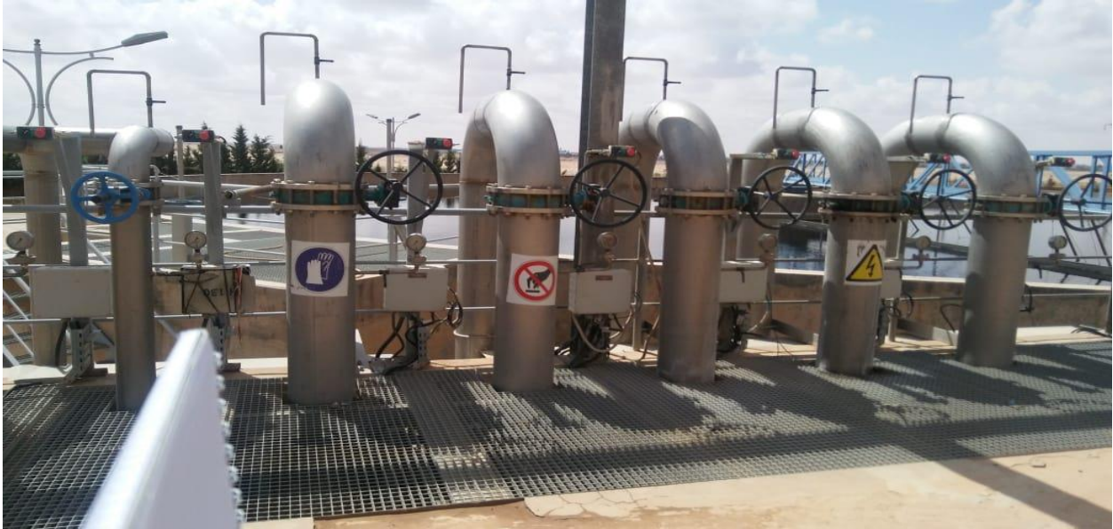
Figure 36 : les pompes de La décantation STEP de Laghouat .
