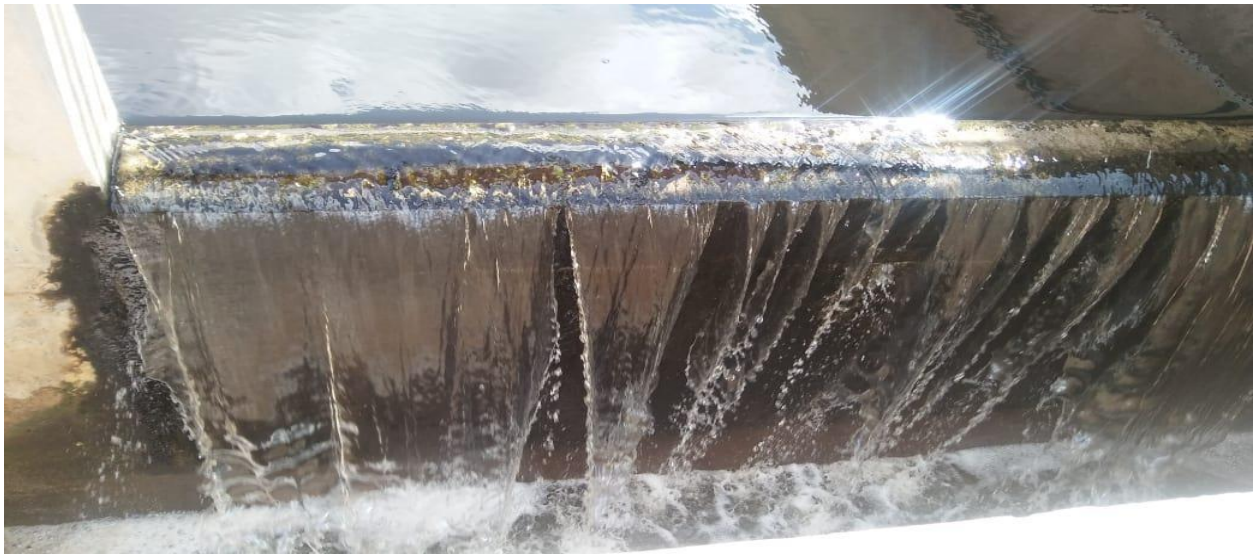
Figure 38 : la sortie de l'eau épuré STEP de Laghouat .
