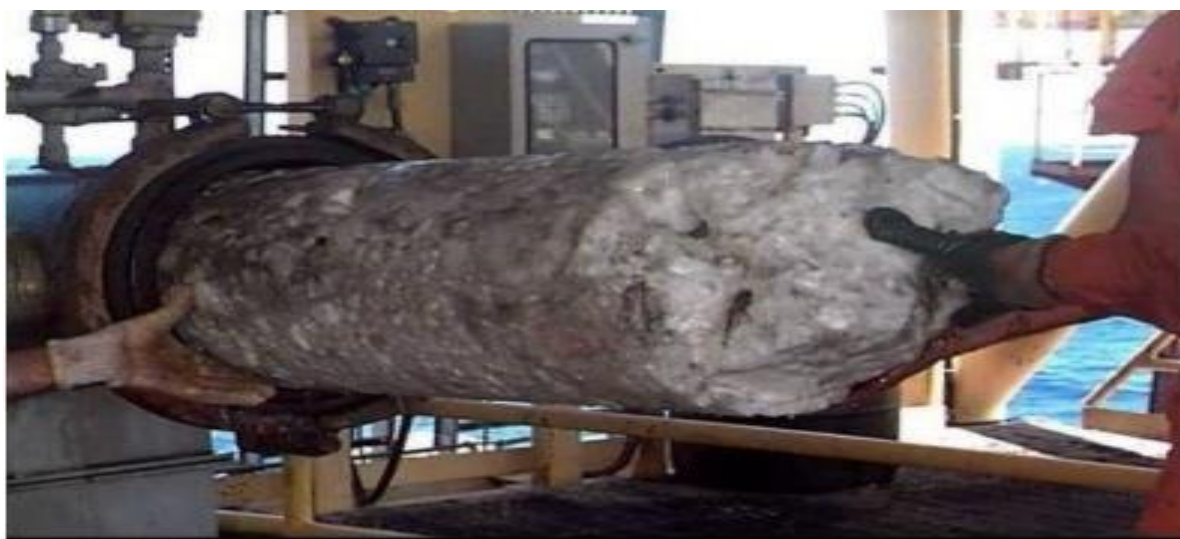
Figure 1: colmatage par les hydrates.
