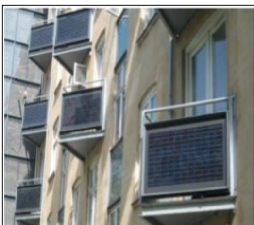
Photo 3 : les panneaux solaire sur les vérandas
